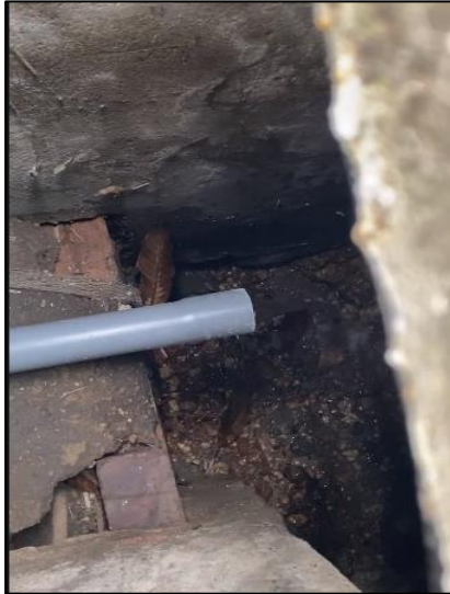
Đường ống thoát nước thải ra cửa xả
