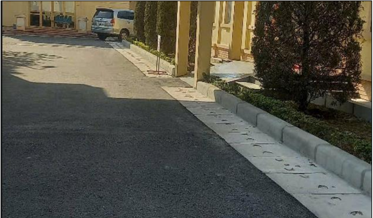
Hình 7. Hệ thống thoát nước mưa có nắp đập
