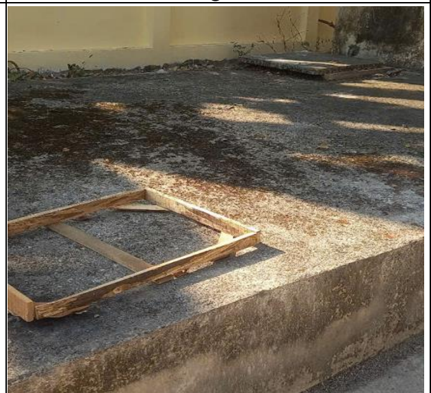
Bể điều hòa
